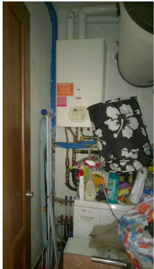
foto 22 – vista C.T. piano interrato
